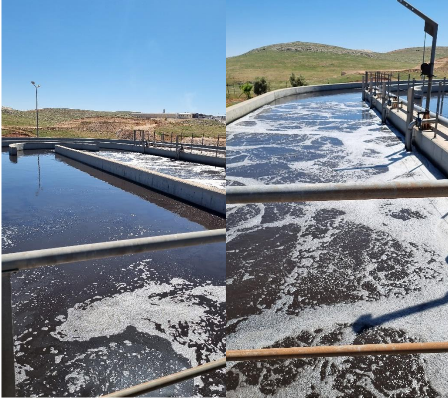
Şekil 5. Şanlıurfa OSB AAT biyolojik arıtma havuzları
