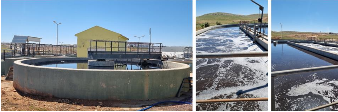
Şekil 6.4 SUOSB AAT Çöktürme Havuzu ve Biyolojik Arıtma Havuzları
